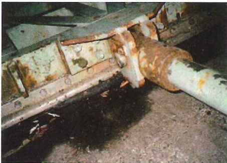
取水ゲート扉体の腐食による劣化
