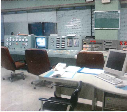
笹ヶ峰ダム監視操作室の老朽化による故障
