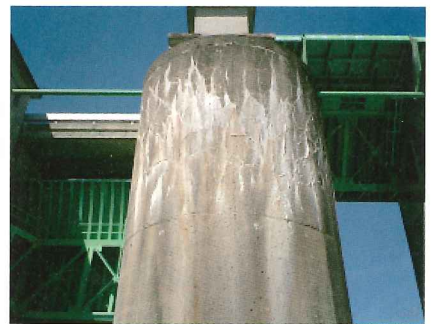
余水吐ゲートのコンクリートひび割れによる劣化
