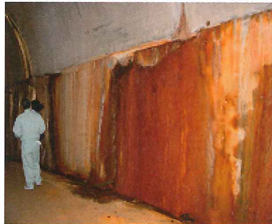
下流管理用道路トンネルの凍結による劣化
