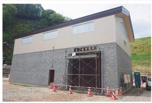
笹ヶ峰発電所建屋
