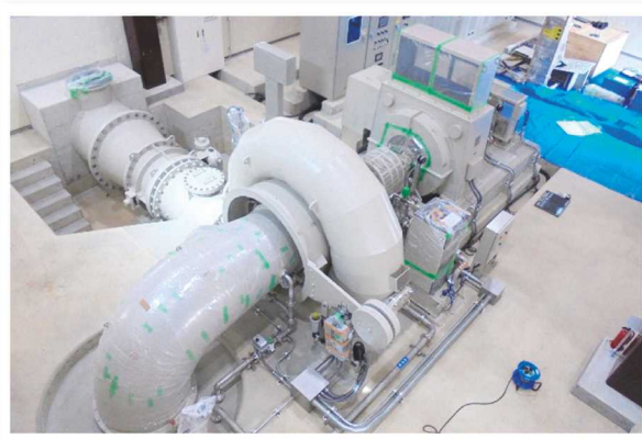
笹ヶ峰発電所内部の様子
