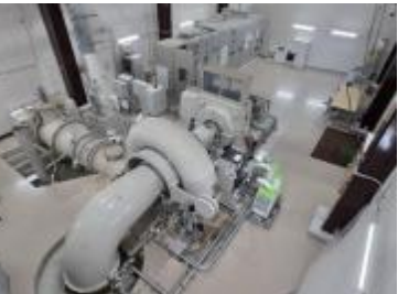
小水力発電所内
