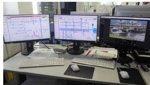
【中央管理所 水管理システム(モニター)】
